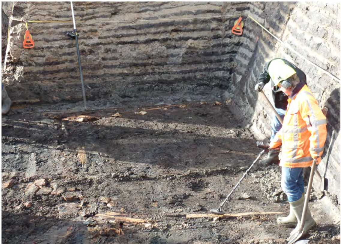
Afb. 5.13. Overzicht palenrijen en staander-ligger constructies haaks op de perceelgrens. Op de achtergrond is de 14de-eeuwse funderingsleuf met spekkeokgelaagdheid zichtbaar.
