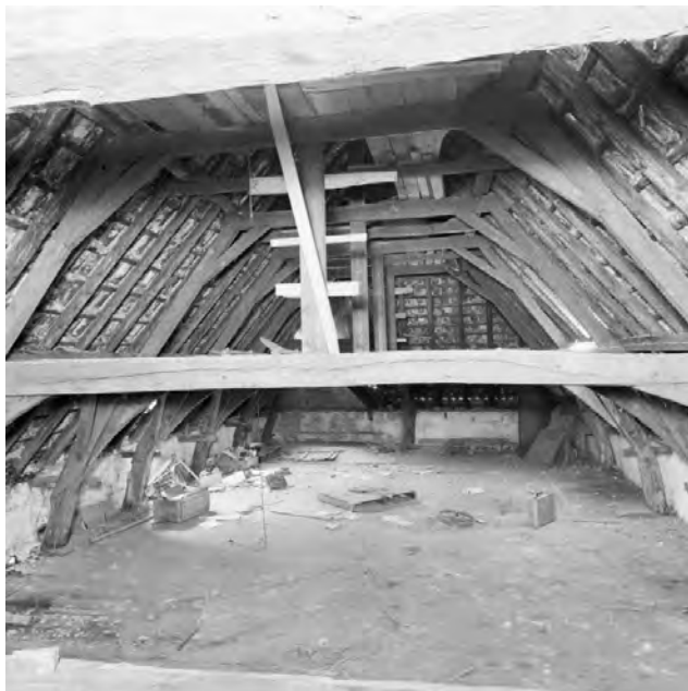
Afb. 4.2. De kap van de woning aan de Nieuwstraat 35 (Foto A.J. van der Wal, 1986, Collectie Rijksdienst voor het Cultureel Erfgoed, obj.nr. 263.143).
