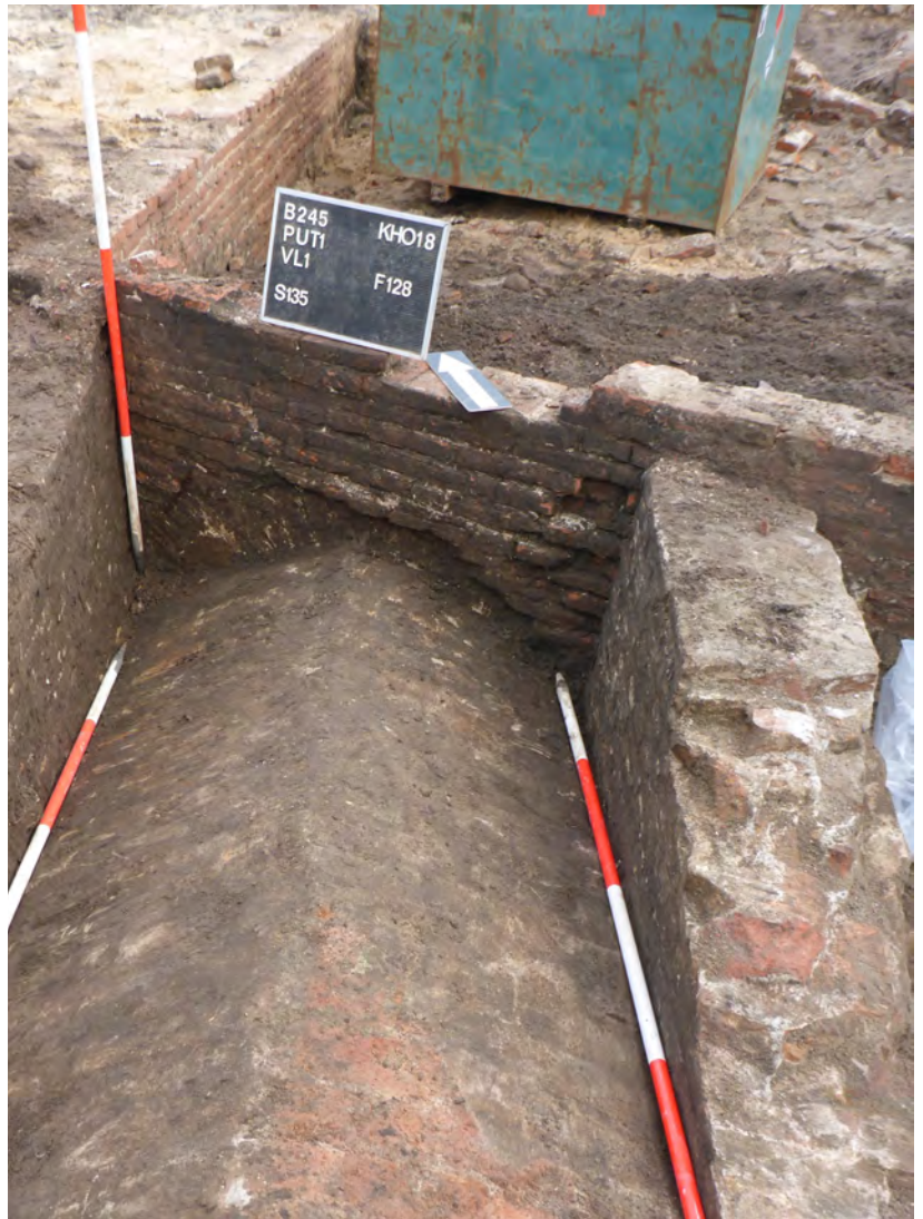
Figuur 40. Met behulp van een spaarboog sluit riool S135 aan op een oudere, overkluisde waterloop (S500) uit fase 4.
