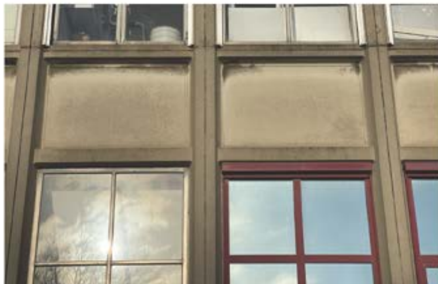
Afb. 36 Ook in het dienstengebouw (hier) en het pompgebouw zijn prefab betonelementen toegepast voor de stalen ramen, gecombineerd met een bakstenen onderbouw.
