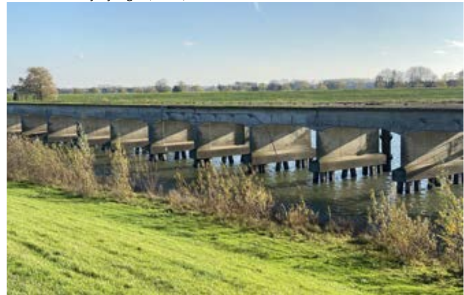
Afb. 20 Restant van de kolensteiger in de zuidelijke haven met een vergelijkbare constructie als de basis van de kolentip, zie de afbeelding hiernaast.
