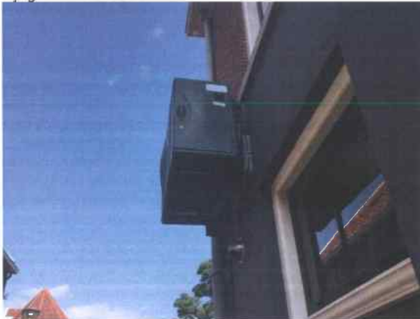
Onderaanzicht koelinstallatie pal onder raam woning Broerenkerkplein 5.
