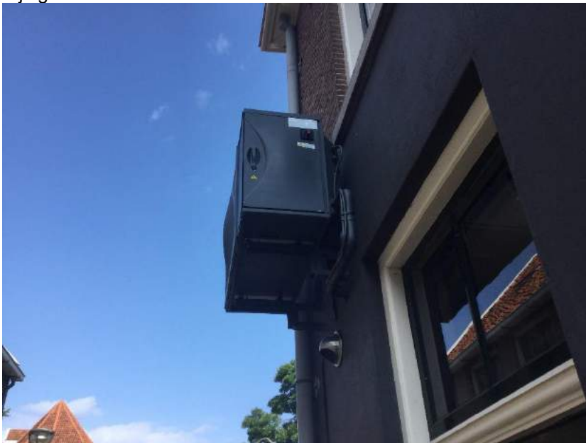
Onderaanzicht koelinstallatie pal onder raam woning Broerenkerkplein 5.
