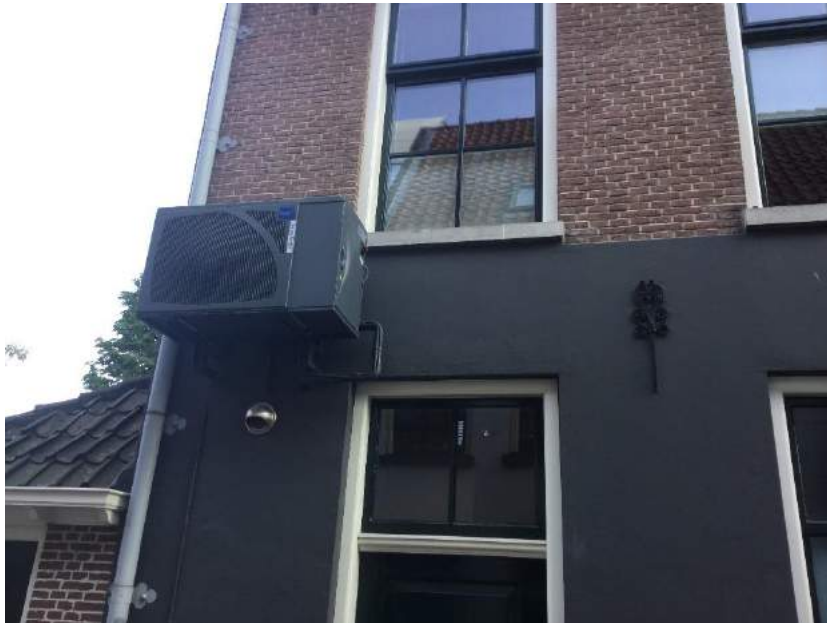
Voorzicht koelinstallatie. Onderraam is winkelpand, bovenraam is woning Broerenkerkplein 5
