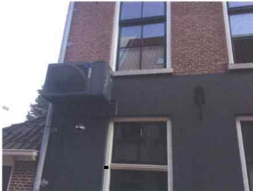
Voorraanzicht koelinstallatie. Onderraam is winkelpand, bovenraam is woning Broerenkerkplein 5
